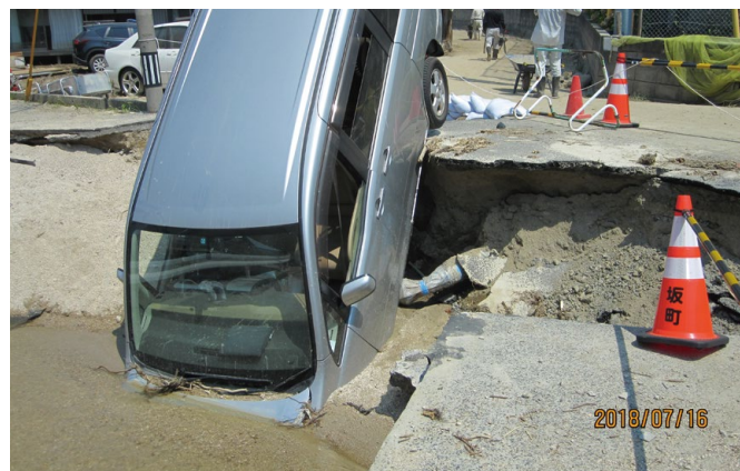
▲豪雨の影響で道路が壊れています。
